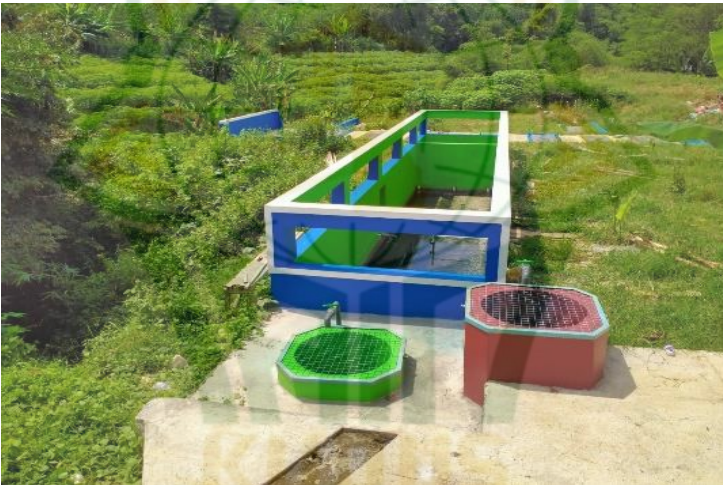
Gambar 1.2 bangunan tandon P1 proses alamiah bubuk sampah
